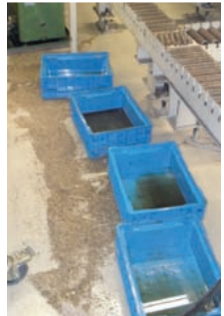
Unhaltbarer Zustand im Gebäude 35 in Hedelfingen: In der Hinterachsmontage im Tausch haben sich Öllachen gebildet, weil Öl aus dem Obergeschoss durch die Decke tropft
